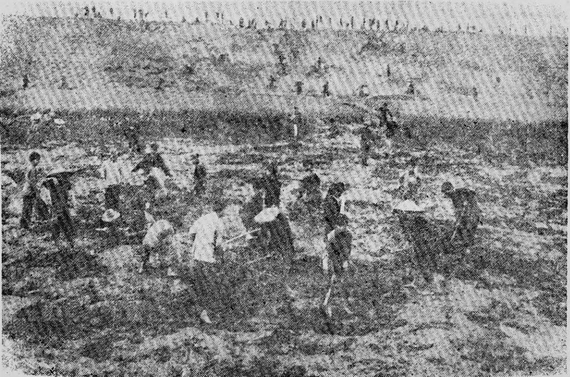
MIENTRAS EL CAMPO socialista trabaja y construye, apoyado en el internacionalismo, en Vietnam los imperialistas destruyen vidas y bienes. En la foto: el pueblo vietnamita repara los cuantiosos daños provocados por los bombardeos yanquis a los diques del delta del río Rojo.
